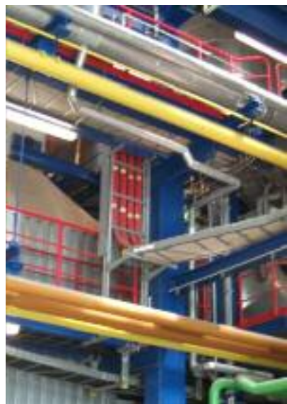
Die auf drei Etagen verteilte Leitungstechnik im Turbinenhaus der Anlagen 1 und 2 der Stadtwerke Erfurt.
